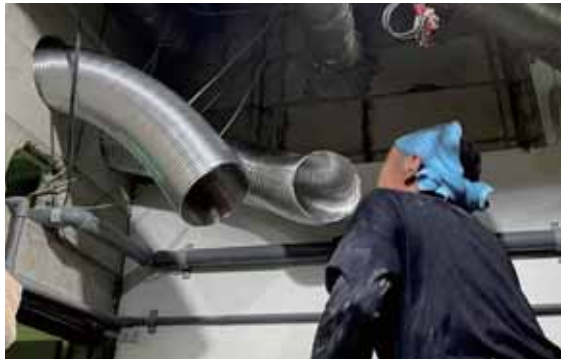
未使用の換気ダクトを活用
